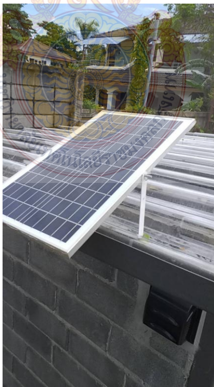
ภาพที่ 4.6 แผงพลังงานแสงอาทิตย์ขนาด 100 วัตต์
