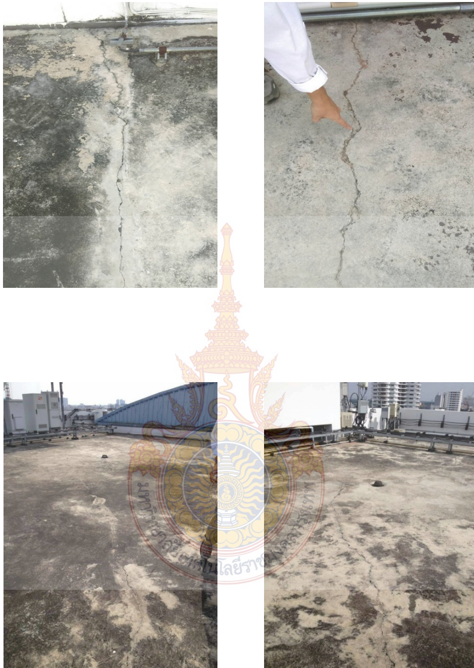
ภาพที่ ก.3 การวัดรอยร้าวของพื้นดาดฟ้าอาคาร
