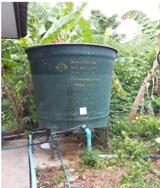
รูปที่ 4.2.1 ถังพักน้ำเพื่อนำไปใช้ล้างภาชนะและวัตถุดิบ
