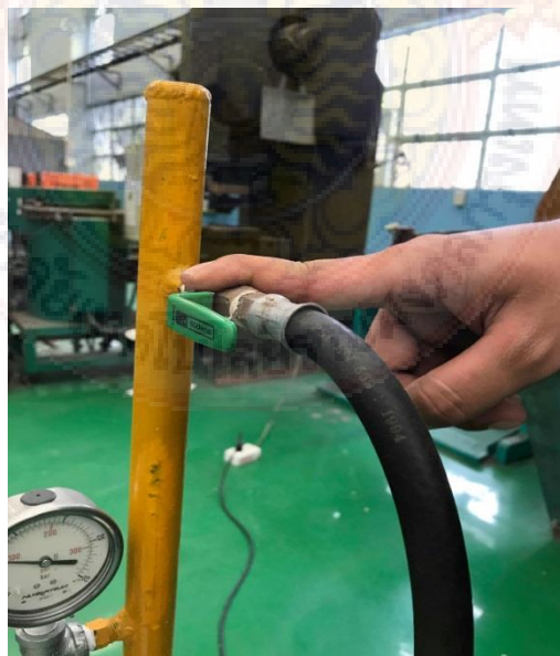
ภาพที่ ข 5 เปิดวาล์วท่อลำเลียงเชื้อเพลิงแก๊สปิโตรเลียมเหลว
