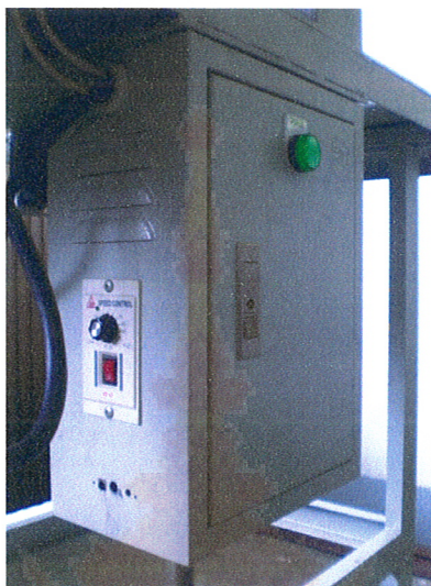
ภาพที่ 4.19 ลักษณะของตู้ควบคุม
