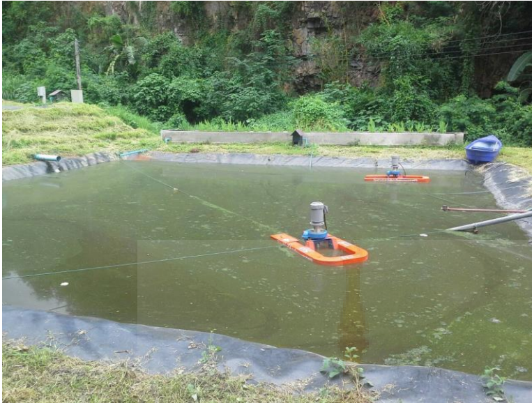
รูปที่ 4.6.10 เครื่องเติมอากาศในบ่อสุดท้าย
