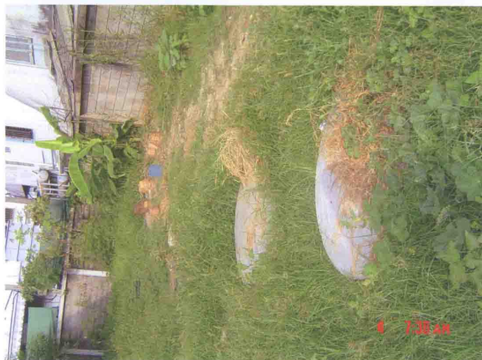
รูปที่ 4.11 ระบบบ่อหมัก และบ่อซึม
