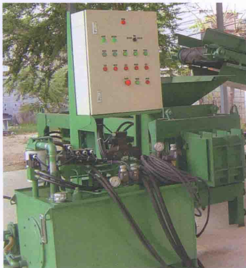
รูปที่ 4.5 ระบบควบคุมการทำงานของเครื่องอัดแน่นขยะ
